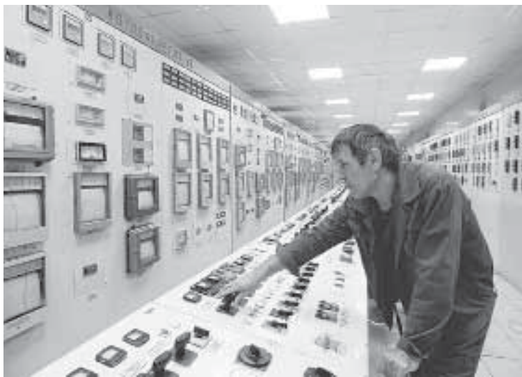
У щита управления машинист котлов №№ 7-11 Владимир Мальгин.
