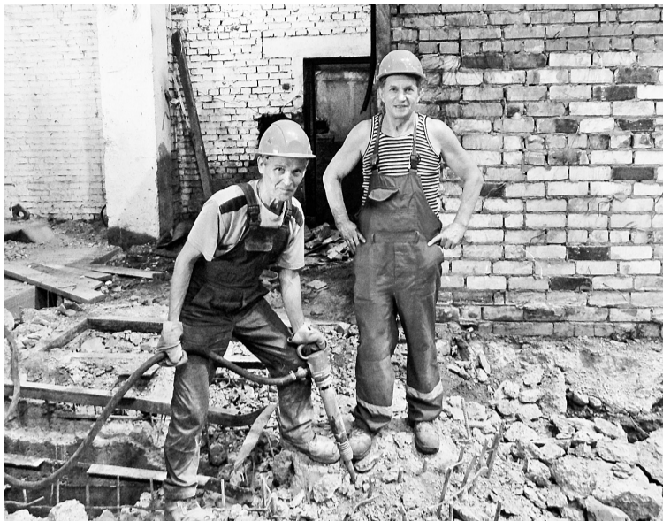
Бетонщик Е.Н. Бессонов и каменщик В.А. Тупарев на подготовительных работах в ЦОГП
