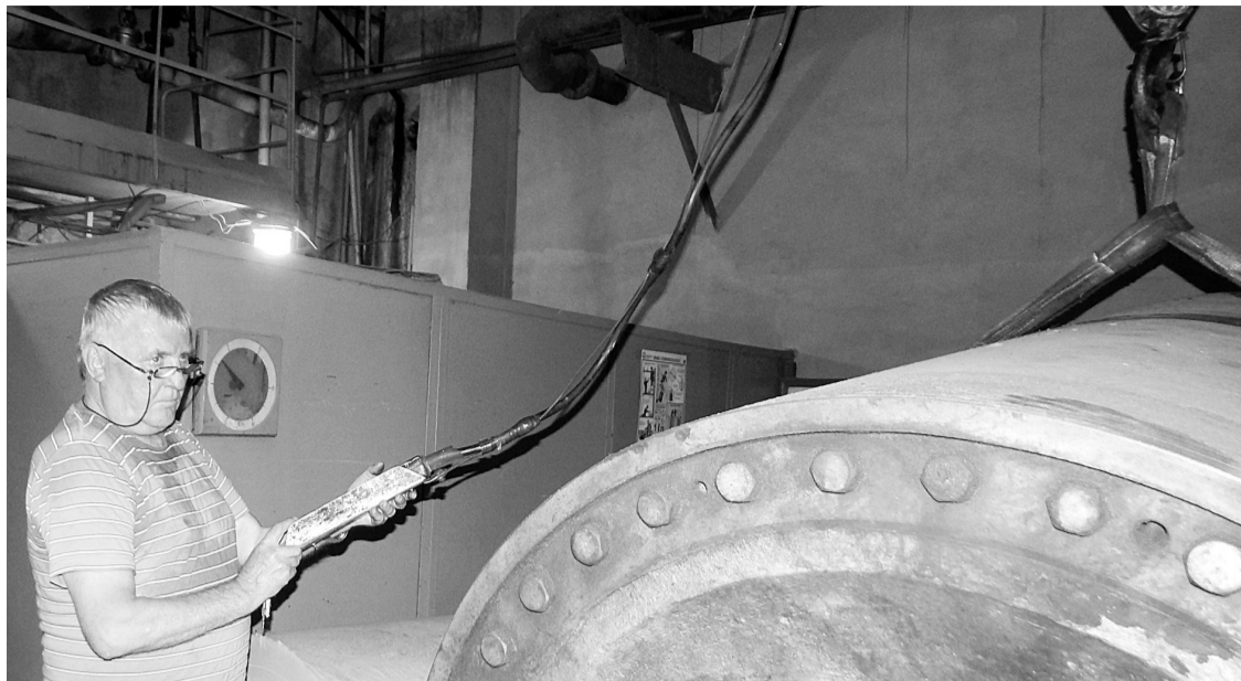
Электромонтёр по ремонту и обслуживанию электрооборудования БП №1 И.П.Девятков проверяет электрооборудование тельфера
