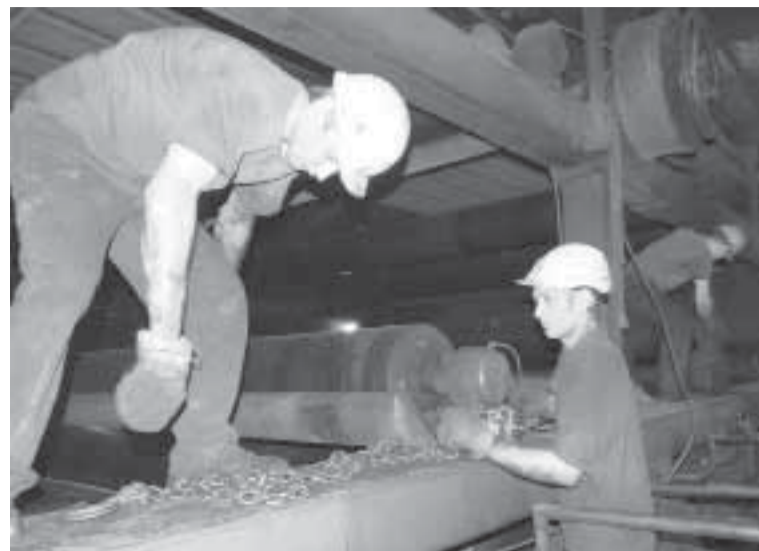
Ремонт паразитного привода сушильной группы. Демонтаж сукноведающего валика производят Евгений Мельник и Олег Бакариус.
