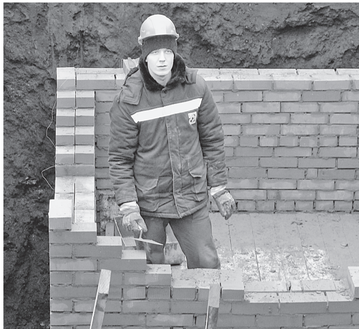
РСЦ строит новую камеру под задвижки на одном из участков противопожарных трубопроводов. Каменщик-бетонщик РСЦ С.Ю. Пеленёв
