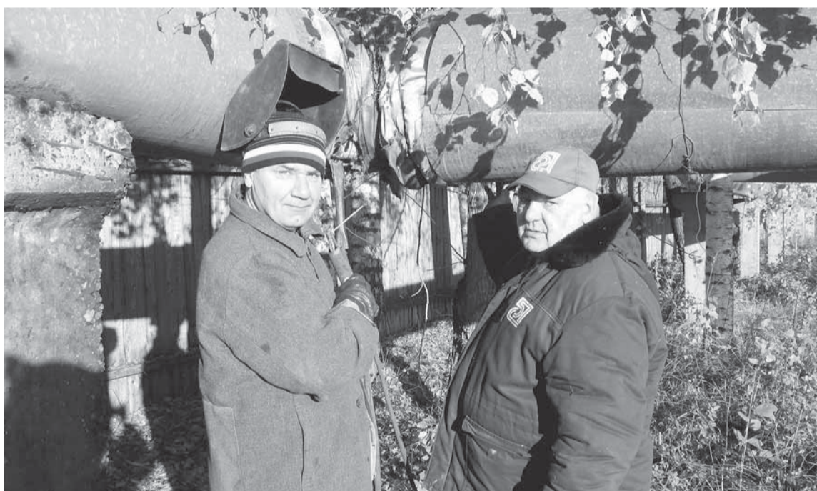
Сварщик Дмитрий Николаевич Кокшаров и бригадир слесарей участка по ремонту теплосетей Виктор Иванович Протасов за ремонтом паропровода.
