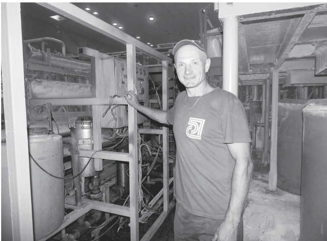
На обходе оборудования у установки «Енисей» аппаратчик химводоочистки Сергей Вячеславович Ужегов.
