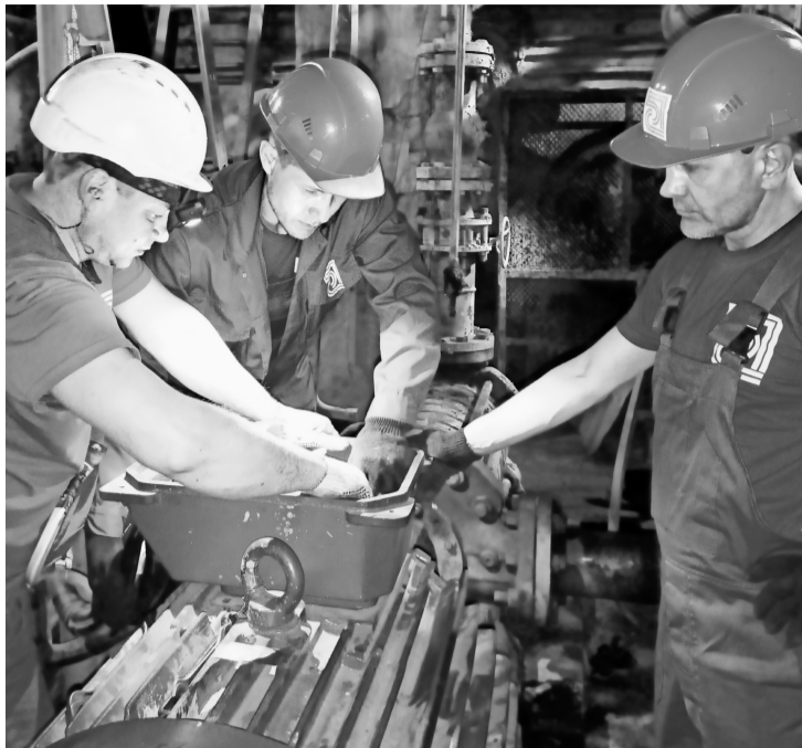
Электромонтёр БП №2 А.Н.Грибанов и электромонтёры по ремонту и обслуживанию электрооборудования энергоцеха А.Н.Меледин и А.М.Большаков подключают кабель двигателя по месту его установки в производстве
