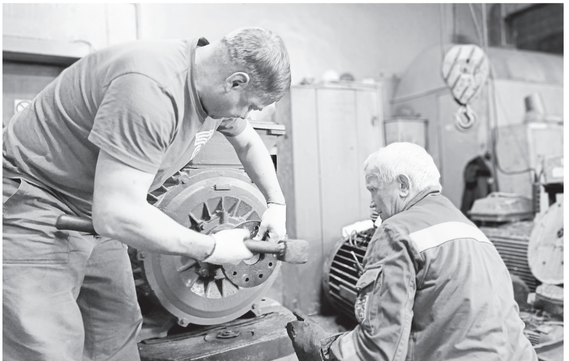
Электромонтёры по ремонту и обслуживанию электрооборудования БП № 2 А. Н. Грибанов и В. Н. Капустин надевают полумуфту на двигатель в электромастерской производства
