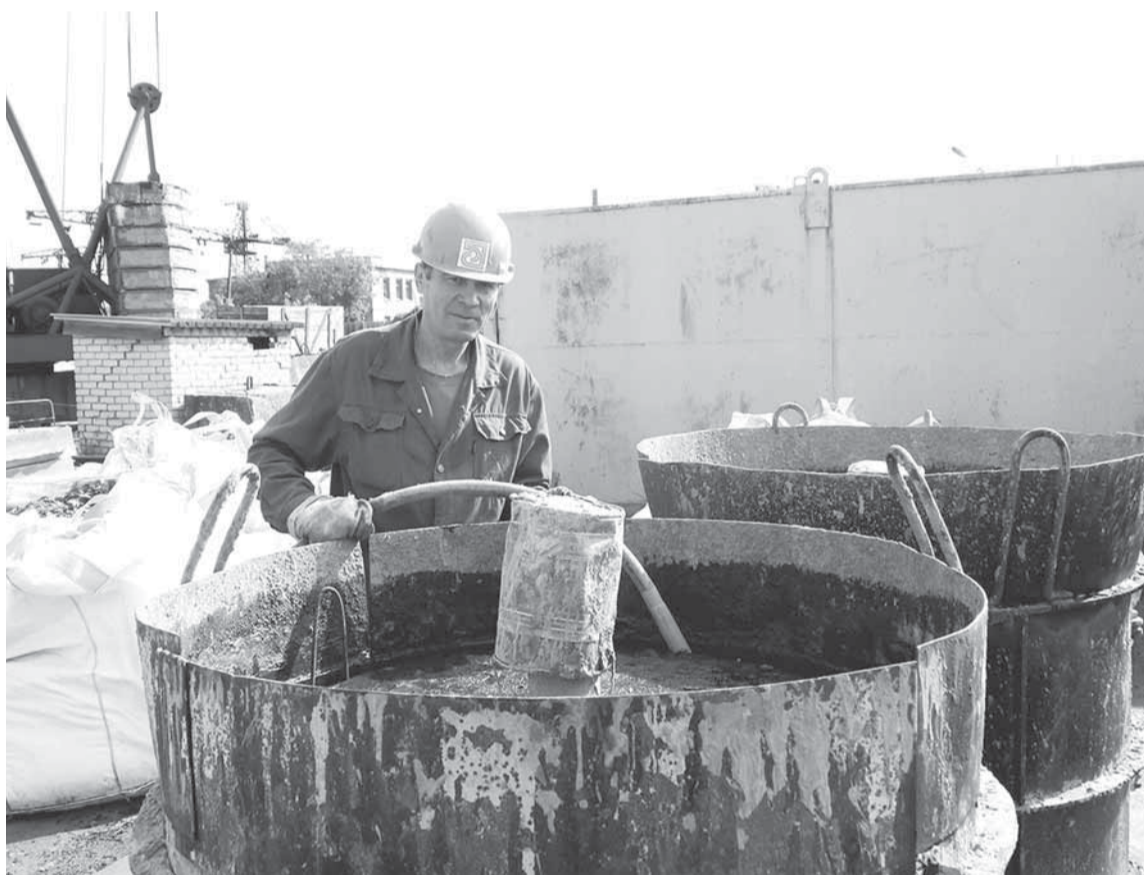
А.В. Киргизов: «Через три часа, когда бетон схватится, будет готово железобетонное кольцо».
