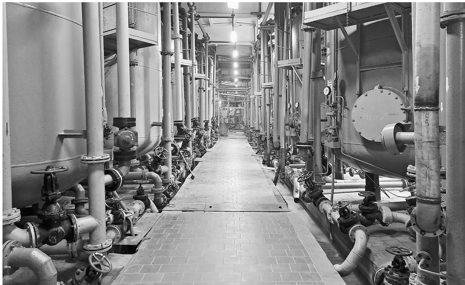
Установка по обессоливанию воды
