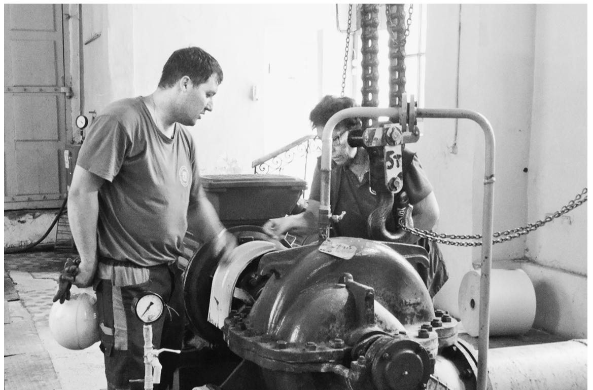
Пуск насосной станции второго подъёма после останова. Старший мастер по ремонту оборудования М.Ю.Куликов и бригадир смены Р.М.Рудачёва
