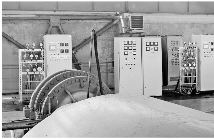
Компрессорный участок цеха водоснабжения
