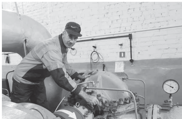
Бригадир М.А. Исаев контролирует оборудование насосной станции.
