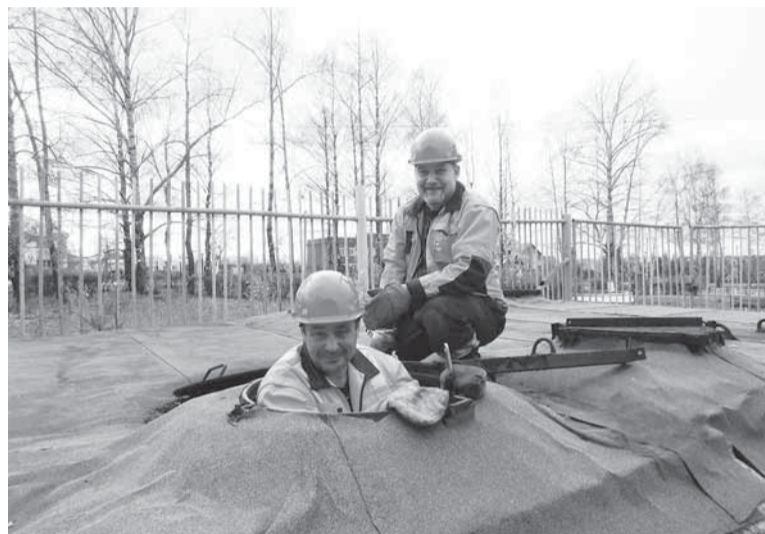
Слесари О.Л. Кетов и О.В. Мальцев после осмотра тепловой камеры.
