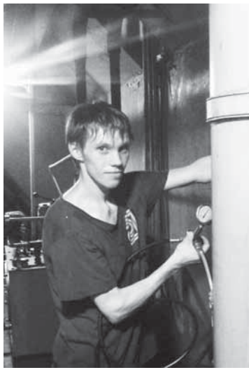
Закачка азотом гидроаккумуляторов системы подъёма вала рафинёра 2.205. На фото И.С. Михайлов.
