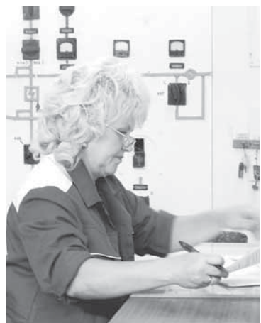
Щит управления мазутно-насосной станции. Машинист Елена Александровна Пайфер фиксирует показания приборов.
